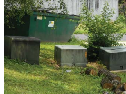
2 EXISTING TRANSFORMERS SCALE: N.T.S.
